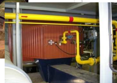
Растопочное устройство котла КЕ-25-24-350
